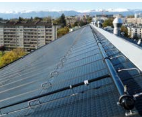
Capteurs solaires thermiques non-vitrés terminés sur Vidollet
